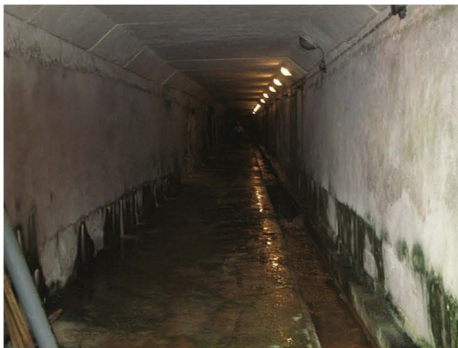
Рисунок 5.1 - Фильтрации воды в потернах бетонной плотины.
